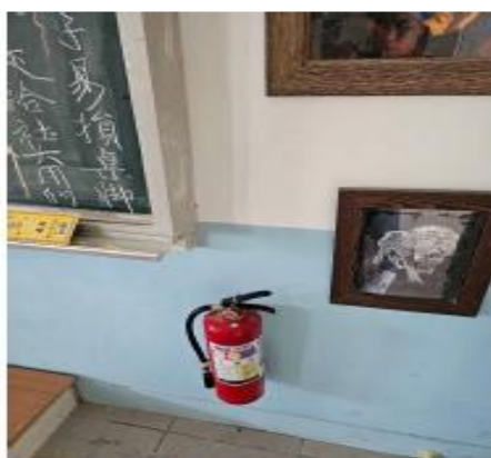
滅火器標示牌補充前
