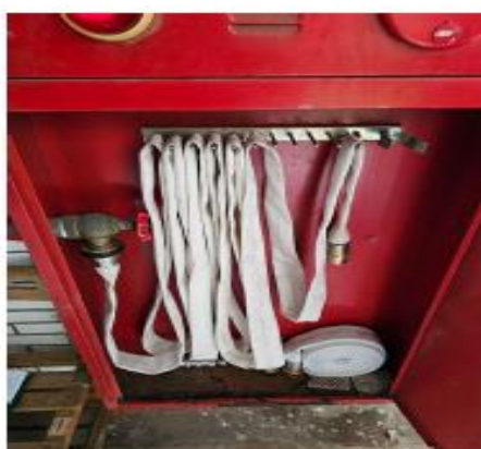
消防水帶更新前
