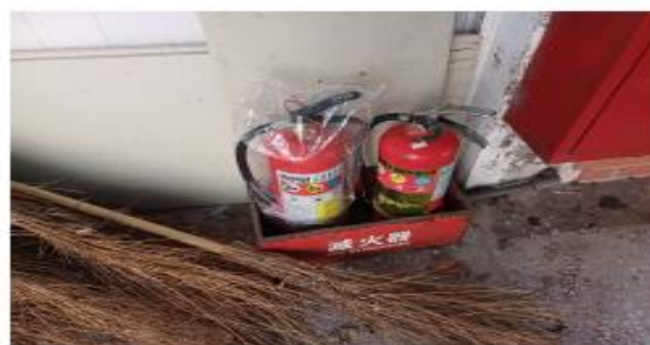
滅火器更新後
